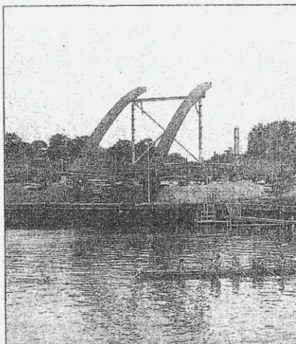
Im Hafen wird jetzt die neue Brücke gebaut, die verkehrstechnisch den Süd- und den Nordhafen verbinden soll. FOTO: A. KÄMPER
